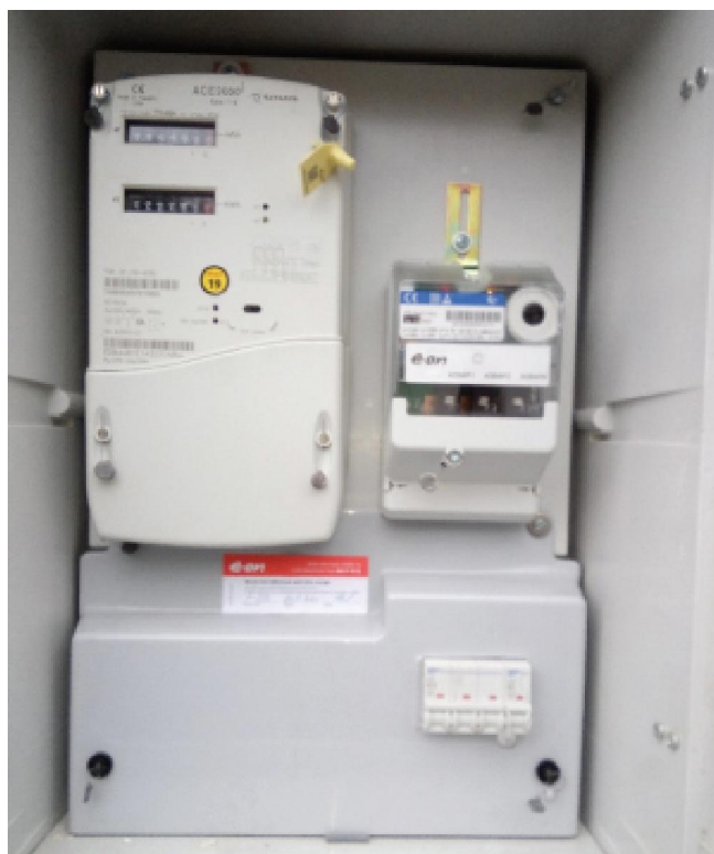
Foto: Příklad elektroměrového rozváděče
